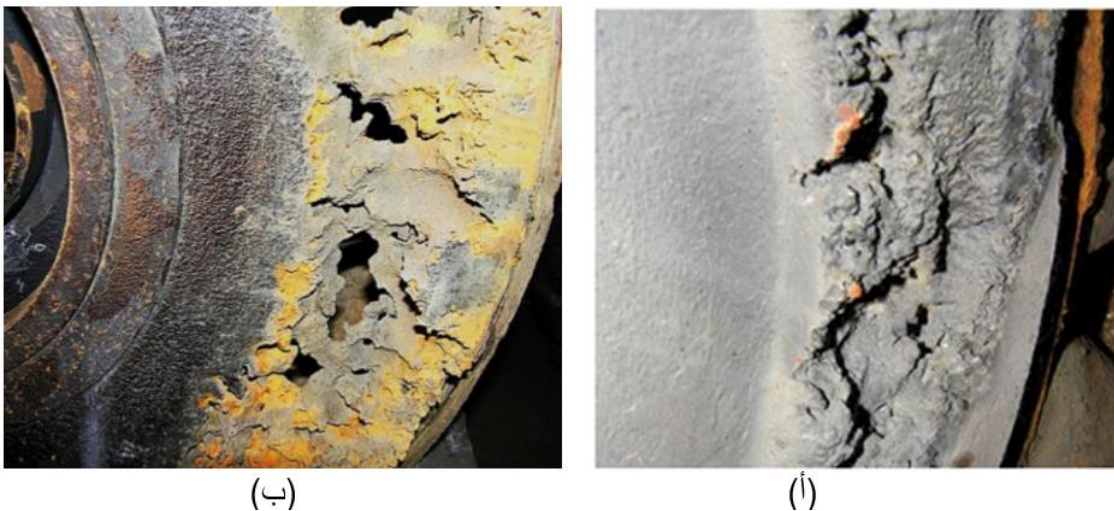
الشكل (1) الصورة النموذجية للضرر الناتج عن تآكل دفاعة مضخة:
